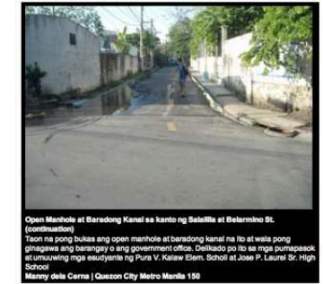
Open Manhole at Baradong Kanal sa kanto ng Salatin at Belarmino St. (continuation) Troon na pong bukas ang open manhole at baradong kanal na lio at wala pong ginagawang ang barangay o ang government office. Delisado po llo sa mga pumapasok at lumalawing mga estudyante ng Pura V. Kilaw Elem. School at Jose P. Laurel Sr. High School Marry dela Cerma | Quezon City Metro Manila 150
